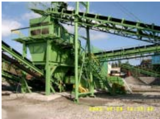
제품선별기 및 송풍기
