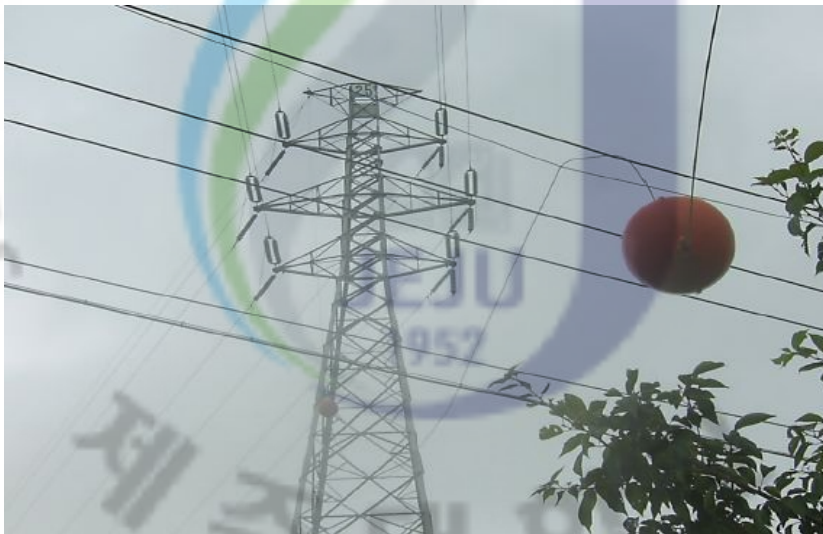
그림 5. 낙뢰에 의한 가공지선 용융 및 탈락
