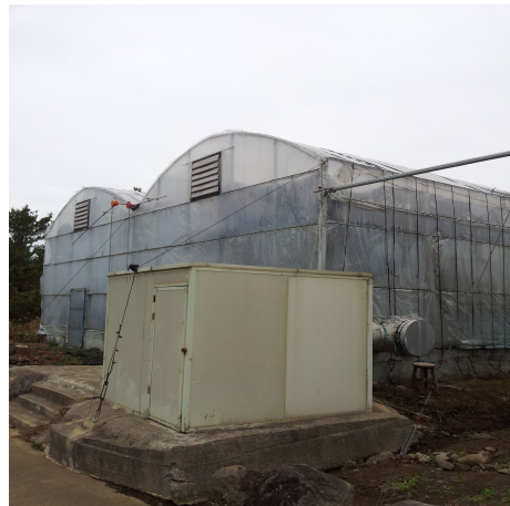
(d) 지하공기 취출시스템의 외부 전경
