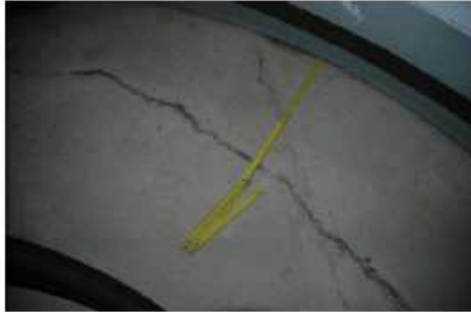
Fig. 19 타워로부터 350mm 거리에서의 균열[14]
