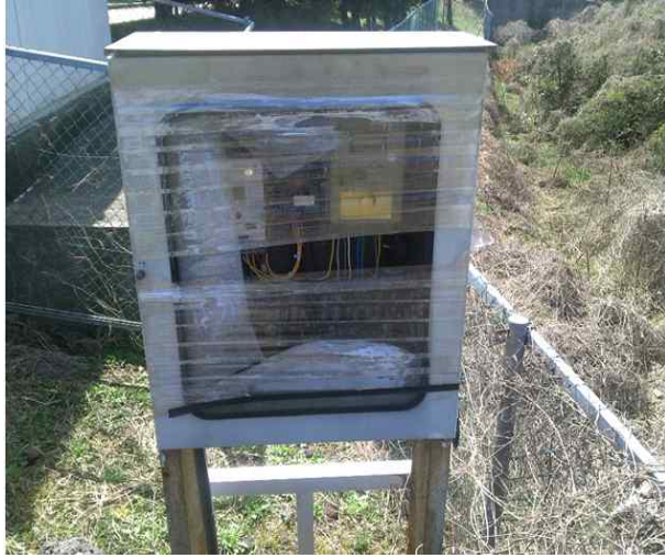
그림 9 한국전력 변전소 내부 행원풍력 전력량계 파손
