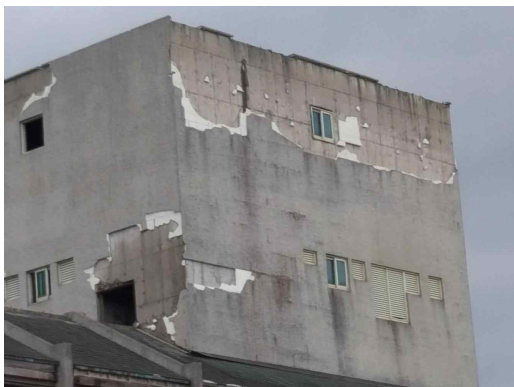
외부 보온재 탈락
