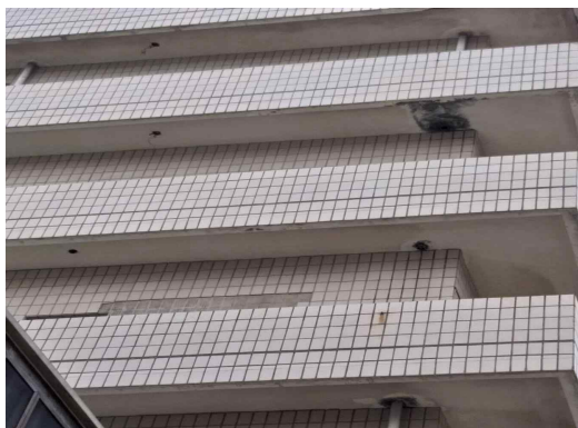
건축물 외장재 탈락(타일)
