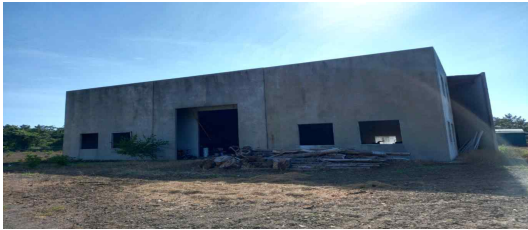
[그림 22] 월림리 공사현장 안전휀스 미설치
