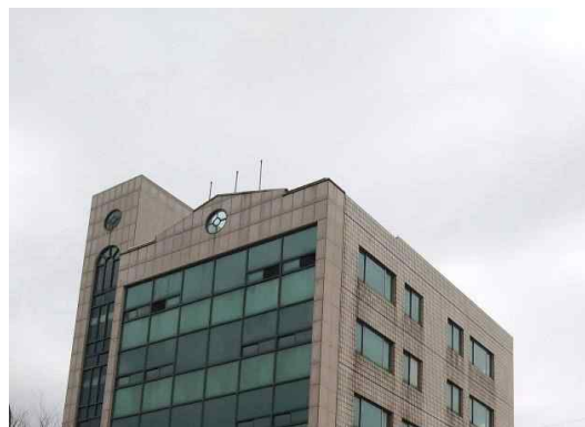
군데군데 파손된 유리창
