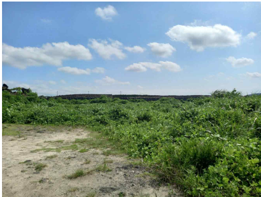
공사현장 무성한 잡풀
