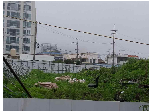
공사현장 내부 쓰레기 방치
