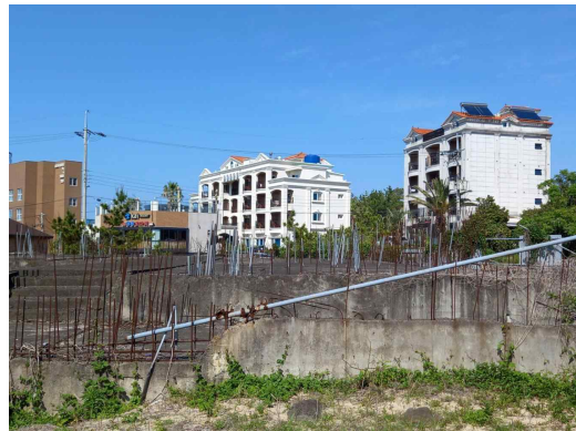
공사장 벽 철근 부식
