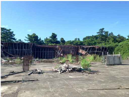
1층 슬래브타설 비계 파손
