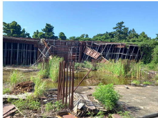
외기노출에 따른 철근 부식
