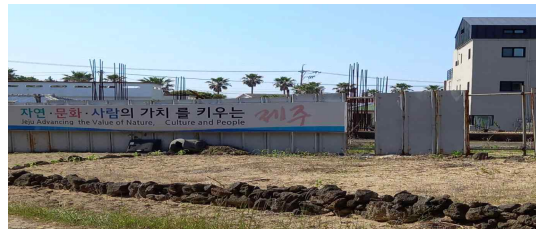
[그림 25] 협재리 관광호텔 공사가림막 파손
