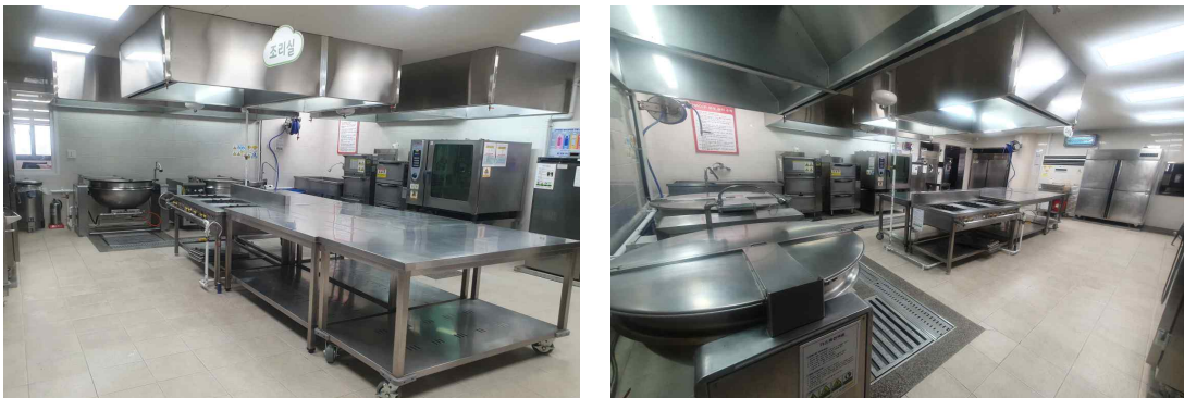
그림 6. 조리장 내 설치된 조명
