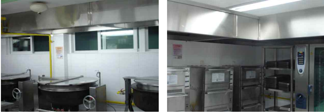
그림 8. 조리장 내 설치된 후드
